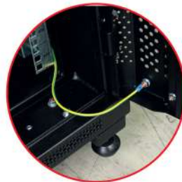
ระบบสายดิน
